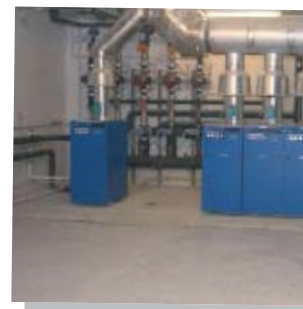
La sala de calderes compta amb les res de seguretat. La climatització es temperatura exterior
