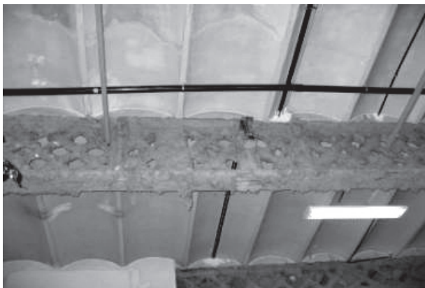
Figura 4. Amianto proyectado en estructura metálica (crocidolita)
